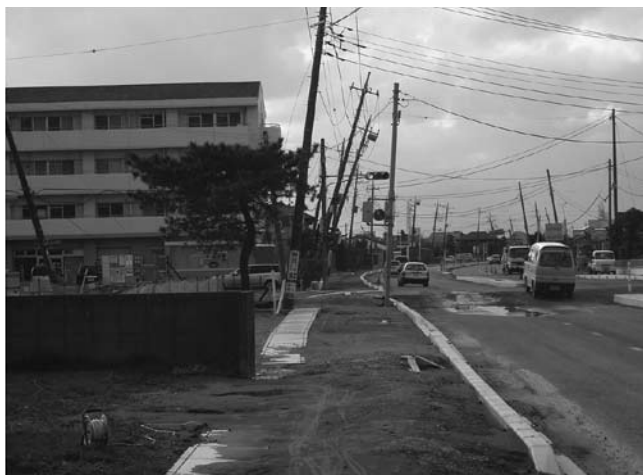
図5 噴砂跡と傾斜した電柱
