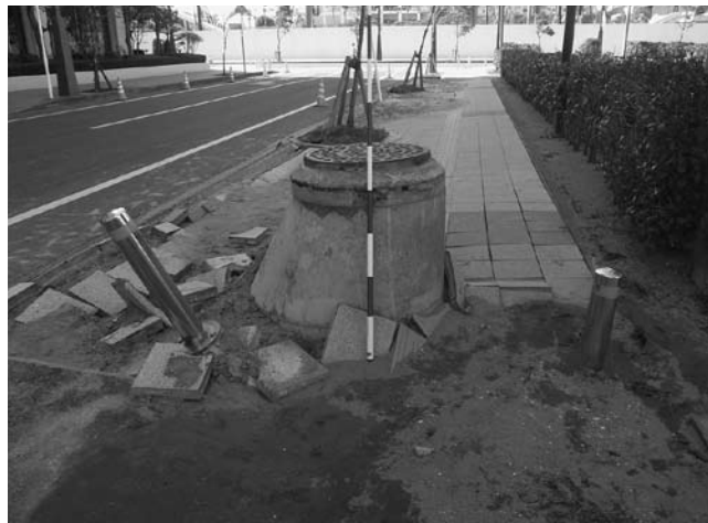
図4 浮き上がったマンホール
