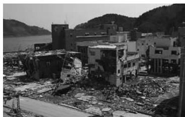
写真5 海に面した鉄筋コンクリート造の建物は、屋上まで津波が来たが形状は保っている。背後の建物は、なんとか残存状況にある（女川港 浸水深約13m）
