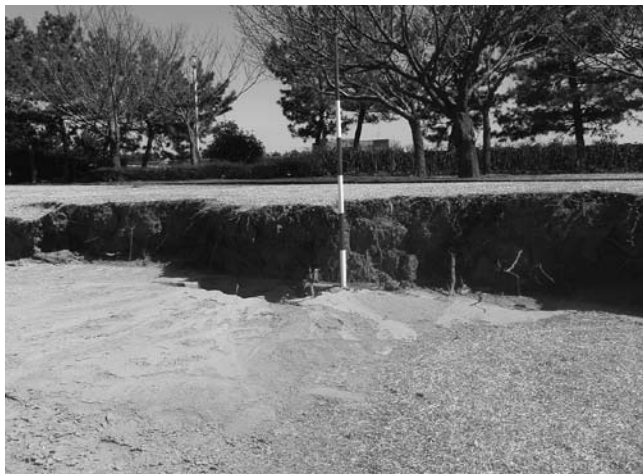
図3 液状化で生じた段差
